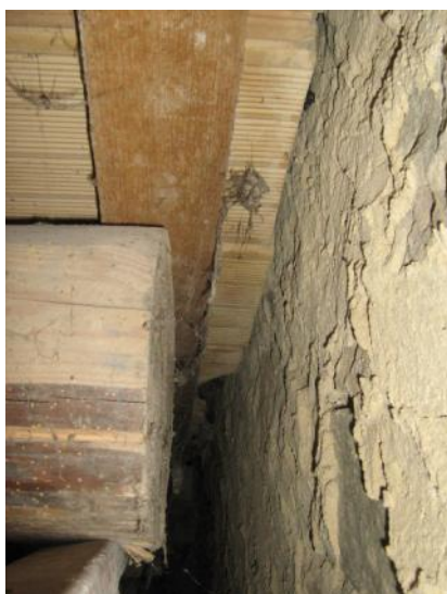
La mancanza di ammortamento della trave nel muro
