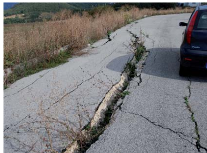
8- Enormi crepe e fessure che si sono aperte sulla strada abbandonata della presupposta area artigianale e delle piccole industrie dei Calderari.
