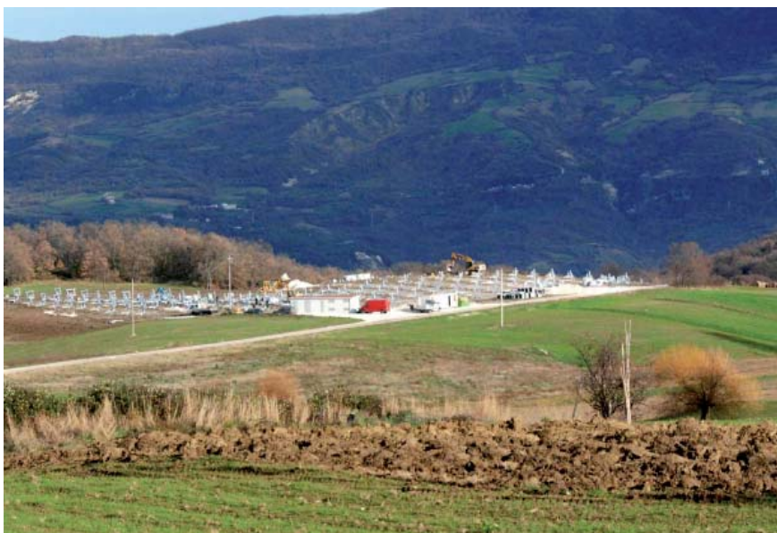
9 – L'impianto fotovoltaico in costruzione. Esso sarà composto da pannelli fotovoltaici che "girano" seguendo il Sole, dunque con strutture più alte degli impianti "normali" a terra.
